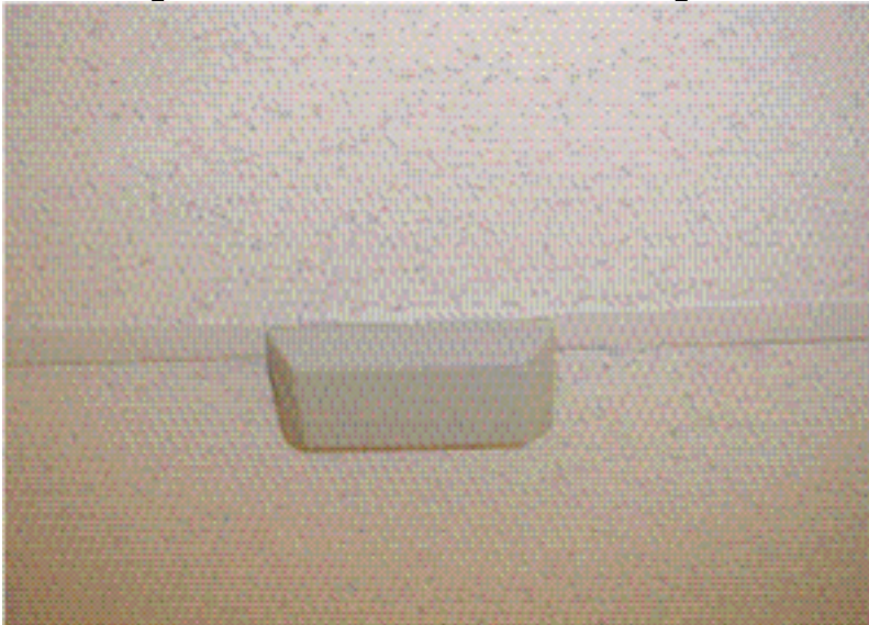
Afbeelding 22-Cisco Aironet 5959 antenne gemonteerd op plafond
