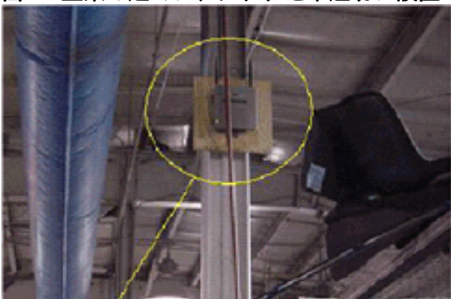
図17:I型梁の近くにアンテナを不適切に設置
