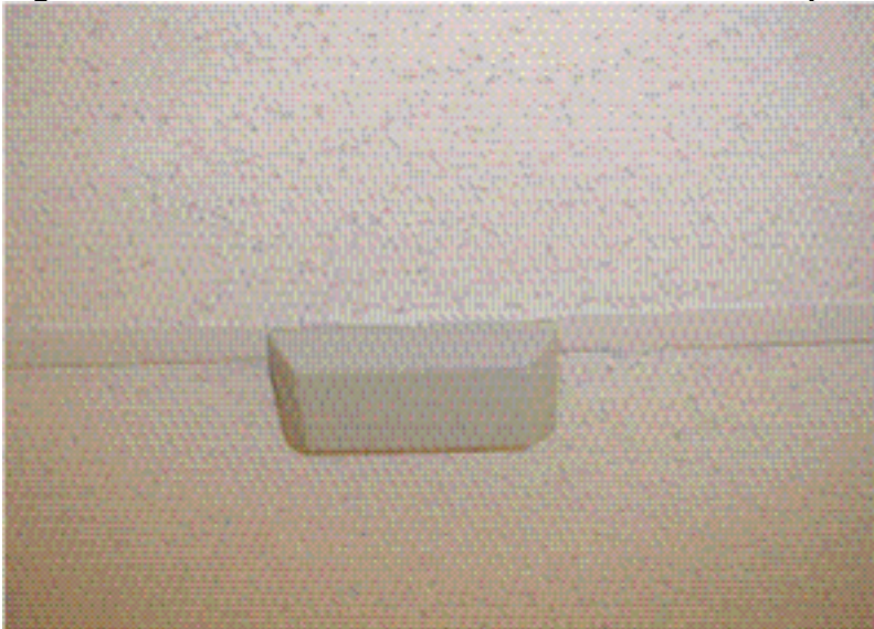
Figure 22 : Antenne Cisco Aironet 5959 montée au plafond
